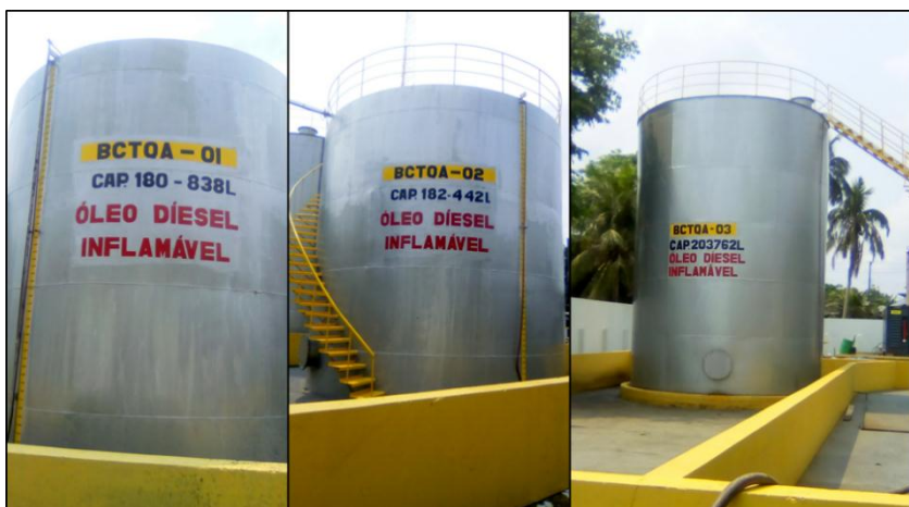
Figura 5 - Tanques de armazenamento de óleo diesel da UTE de Benjamin Constant.
